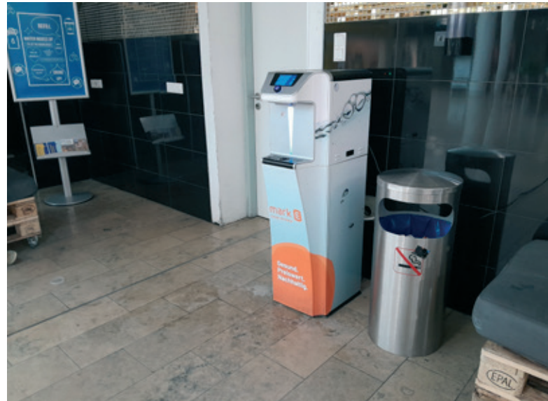
Trinkwasserbrunnen in der Volmegalerie
