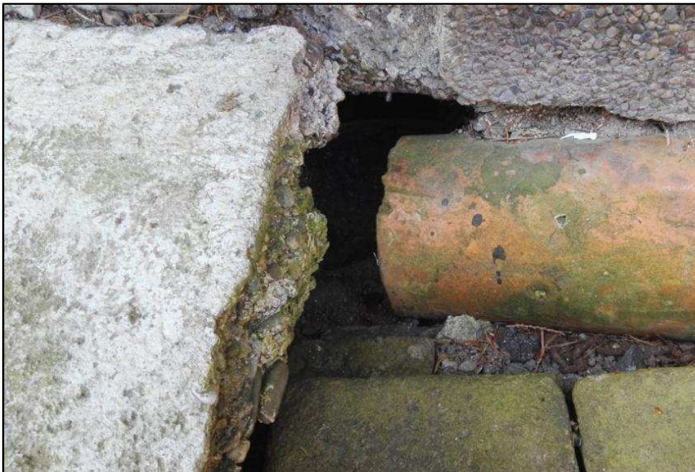
Abbildung 28: Lücken im Mauerwerk zum Kellerraum der Scheune.
