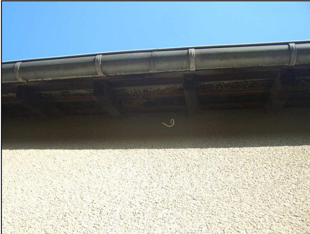
Abbildung 9: Beschädigungen am Holz auf der Nordseite des Wohngebäudes.
