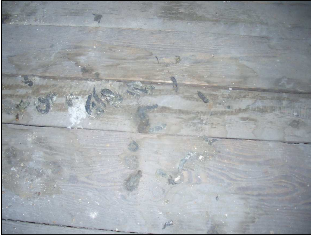
Abbildung 25: Marderkot auf dem Boden des Dachstuhls des Wohngebäudes.
